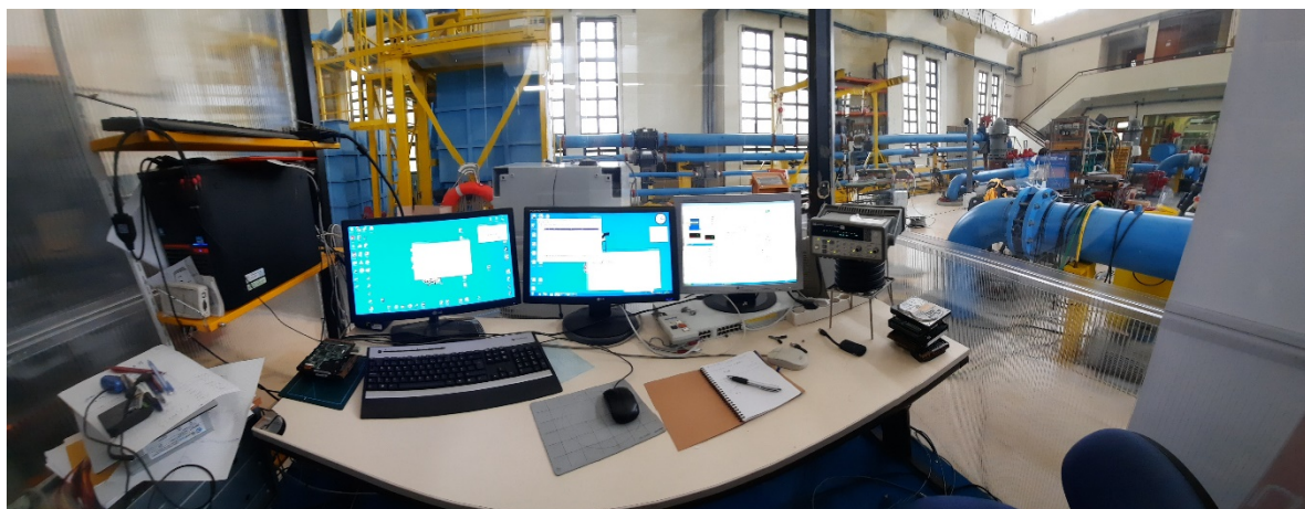
Figura 2.21 – Sala de comando e supervisão da UHM
