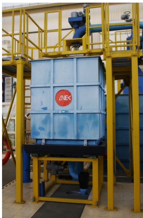
Figura 2.16 – Sistema de pesagem
