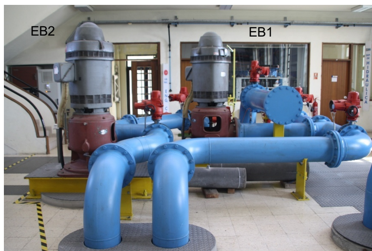
Figura 2.8 – Grupos eletrobomba (EB1 e EB2)
