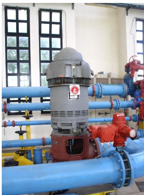
Figura 2.9 – Grupo eletrobomba EB3
