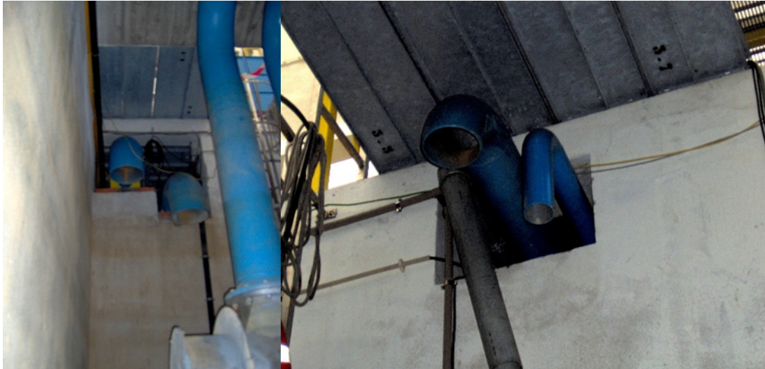
Figura 2.11 – Condutas de retorno de água ao reservatório (observadas do interior do reservatório durante a sua limpeza)
