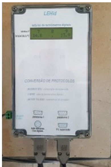
Figura 2.4 – Indicador associado aos dispositivos de medição de temperatura da água
