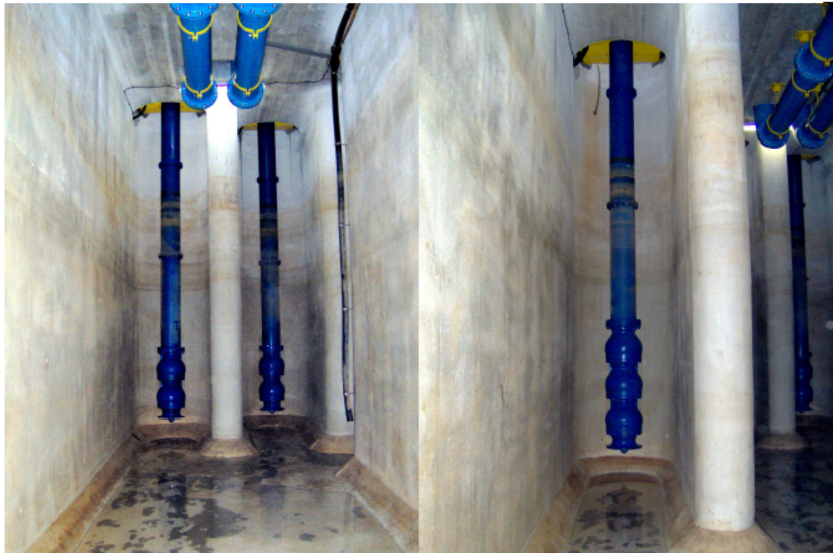
Figura 2.7 – Bombas hidráulicas associadas aos grupos eletrobomba
