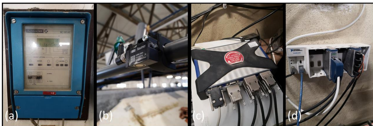
Figura 3.5 - Equipamentos de medição de caudais e de níveis de água. a) Caudalímetro Altometer. b) Sonda Ultrasónica Baumer U500. c) Condicionador de sinal QuantumX MX 840 AZ. d) Placa NI cDAQ - 9172.
