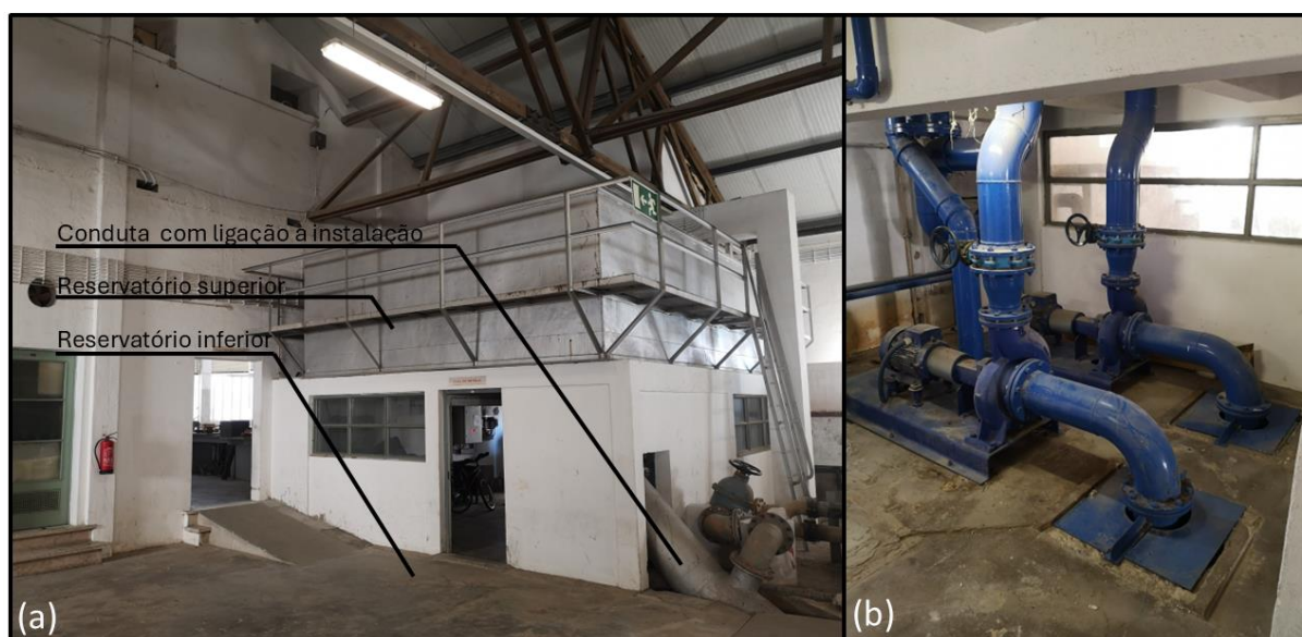
Figura 3.4 - Sistema de alimentação. a) Localização dos reservatórios inferior e superior e da conduta de alimentação. b) Sistema de bombagem com instalação em paralelo.
